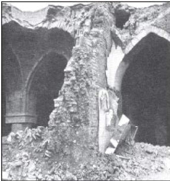
منظری از چشمه های تخریب شده ۴۱-۴۲
